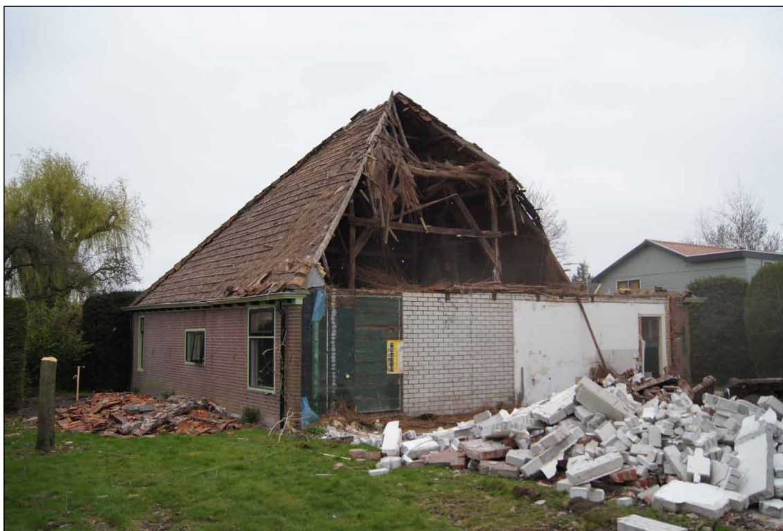
Afb. 16 Het vierkant is aan de achterzijde van de stolp zichtbaar tijdens de sloop.
